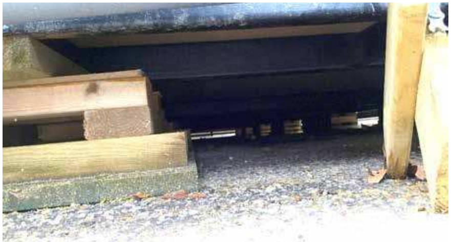
Hållrummen mellan modulerna medför risk för snabb brandspridning till stora delar av byggnaden.
