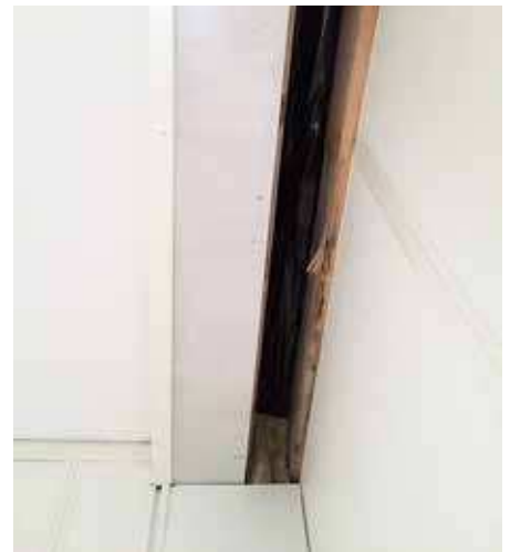
Otätad genomföring vid dörröppning i modulskarv är en brandrisk.
