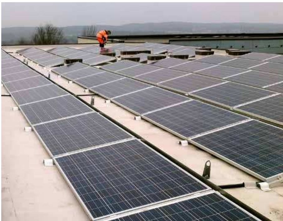
Figur 5. Platt tak med takduk med solcellsmoduler monterade horisontellt (övre) och uppvinklat på metallstativ (undre). Gärdstensbostäder.
