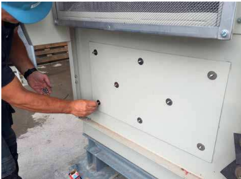
Bild 8. Exempel på installerad CLD-panel. Dämpmaterial pressas mot strukturen via bultar.
