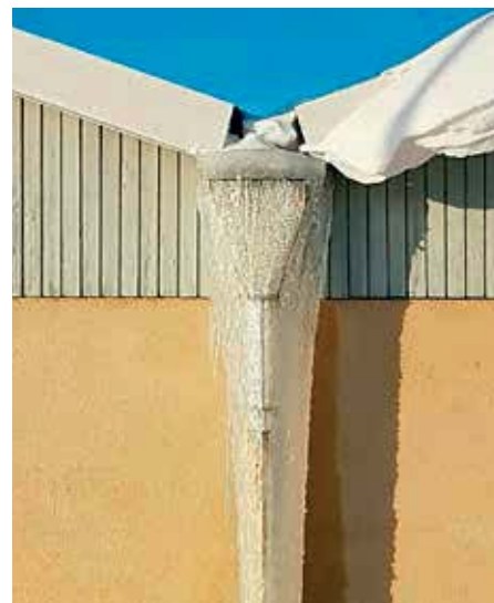
Bild 8. Exempel där vatten frusit i stuprör.
