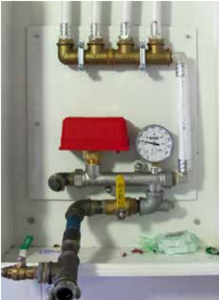
Figur 2. Systemets fördelarskåp med fördelare och flödesvakt innan anslutning till vattenservisen.
