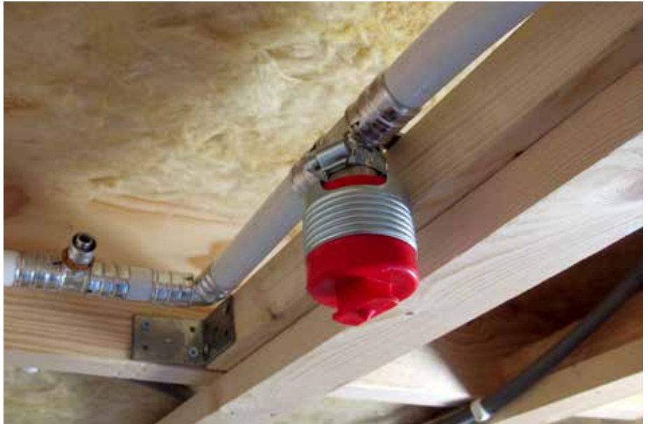
Figur 3. Sprinkler efter installation i bjälklaget. Sprinklern är försedd med en röd täckkåpa med en spets som ger en anvisning var håltagningen i takgipsskivan skall göras. På röret syns även en anslutning för vatten till WCstol.
