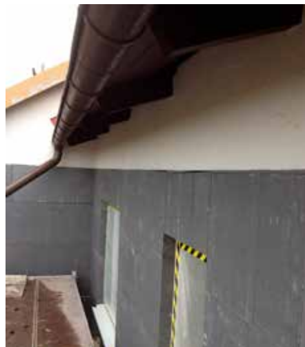
Tilläggsisolering av fasad i ett projekt med kvarboende där brandskyddet är fullgott först när fasaden putsats, en risksituation.
