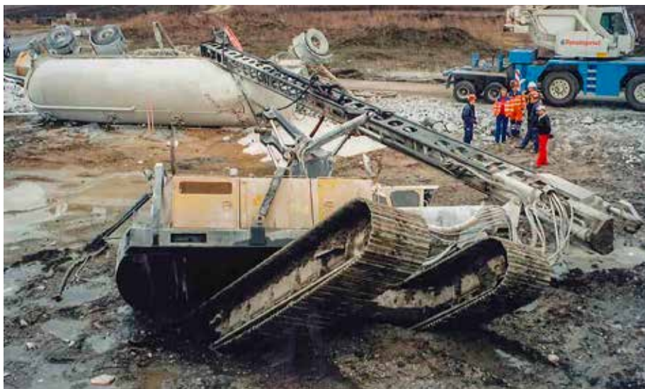
Grundläggningsmaskiner kan inte operera på gungfly utan behöver en i ordningställd arbetsplattform.
