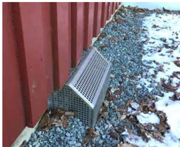
Figur 6. Exempel på utblås från kryppgrund.
