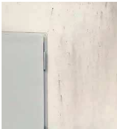
Bild 8: Putsad fasad med missfärgning av mikrobiell påväxt hos träfraktioner i MOC-skivan som felaktigt använts som putsbärare.
