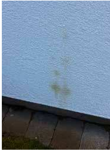
Bild 6: Brun missfärgning av korrosionsprodukter från infästningsskruvar, med lågt korrosionsskydd, i kontakt med fuktig eller blöt MgO-skiva.
