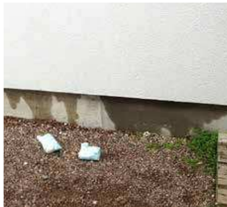
Bild 1: Väska från MOC-skivor har runnit ut genom luftspaltens öppning och missfärgat husets sockel.
