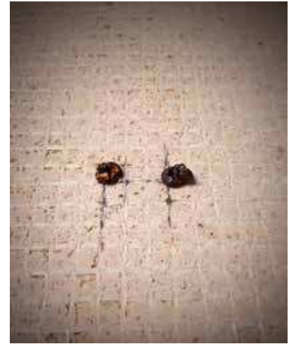
Bild 7: Korrosionsprodukter som bildats på rostfria skruvar i MOC-skiva i klimatbox med 95 % RF.
