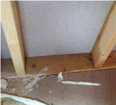
Bild 3: Väska från MOC-skivan har fuktat upp träregelstommen.
