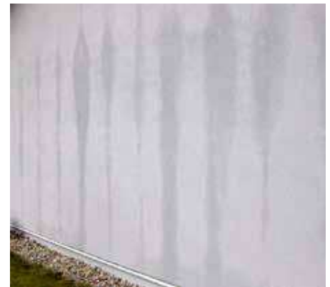
Bild 2: Putsad fasad med missfärgningar vid vertikal träläkt i luftspalten. Träläkten har sugit upp vätska från MOC-skivan samt fuktat upp och missfärgat putsbäranen.
