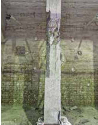
Figur 5. Pelare av armerad betong där kollaps skedde under avsvälningen 2 .
