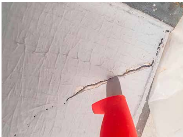
Figur 15. Sprickor och rörelse i avjämningsmassa efter golvvärmestart.
