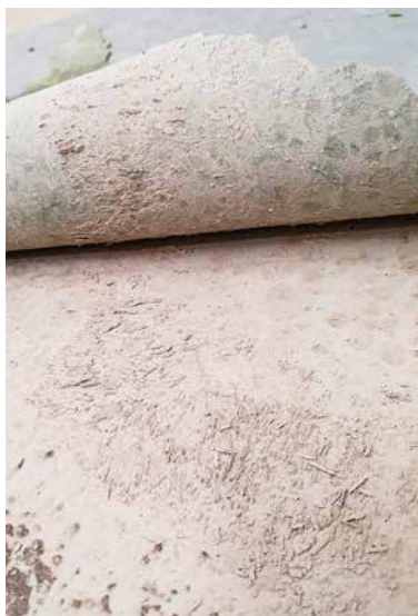
Figur 17. Dålig vidhäftning vid pulveriserad avjämningsyta under tätskiktet.
