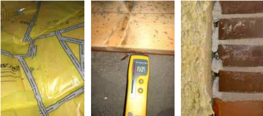
Figur 1. Bilder från nyproduktion vid fuktronder från vänster: skarvad isolering, utfackningsvägg med mögelpåväxt på syllen och avsaknad av luftspalt i skalmur på grund av brukstuggor. I samtliga fall har entreprenören enligt deras uppgift åtgärdat bristerna.
