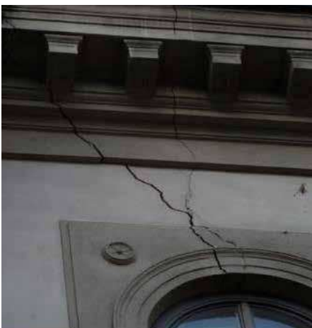
Sprickor i ytter- och skiljeväggar.
